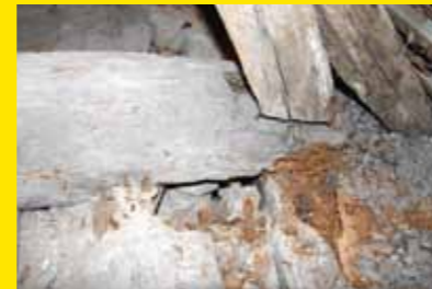
Pilzgeschädigter Auflagerbereich bei Gespärre 5
