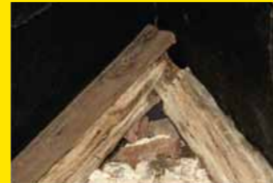
Schadhafte First- verbindung bei Binderespärre 1
